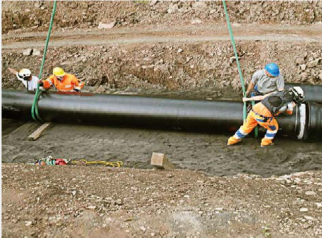
Fig. 9 Certains des tuyaux en fonte ductile vonRoll ont dû être installés par hélicoptère.
