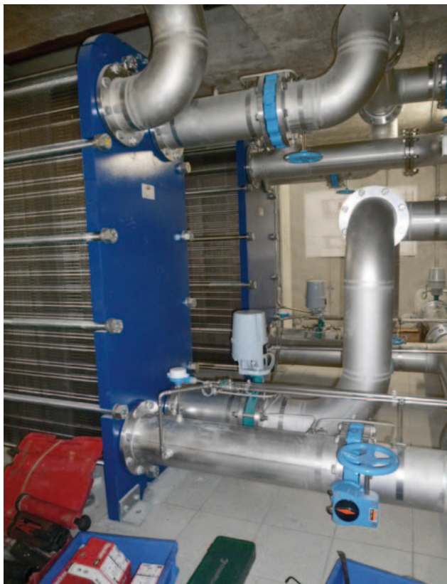
Fig. 2 Wärmetauscher Technikraum Échangeur de chaleur
