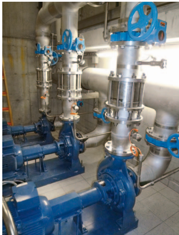
Fig. 3 Rohwasserpumpwerk Technikraum Station de pompage de l'eau brute
